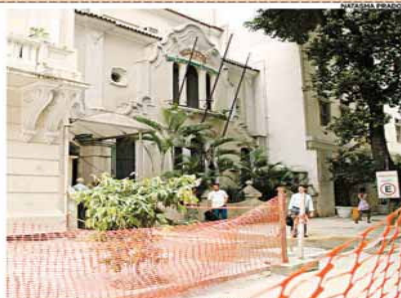
Entrada da Obra Portuguesa foi bloqueada por canteiro
